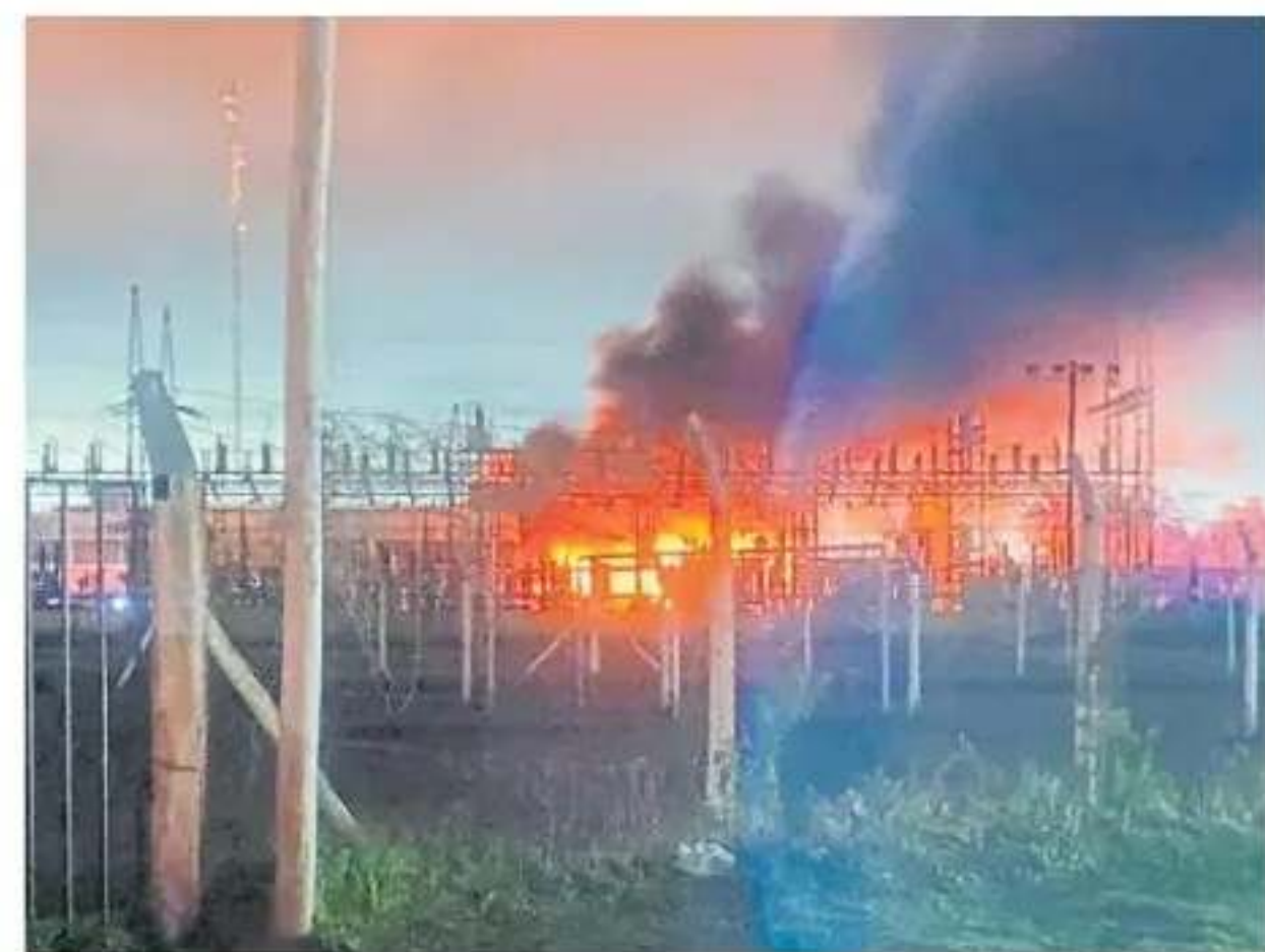
El fuego en la subestación derivó en un apagón
