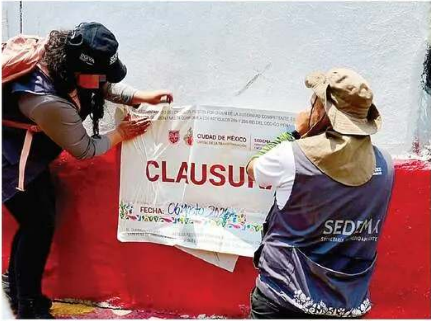
Autoridades colocaron sellos de clausura a las tuberías que conducían aguas residuales a la zona lacustre.
