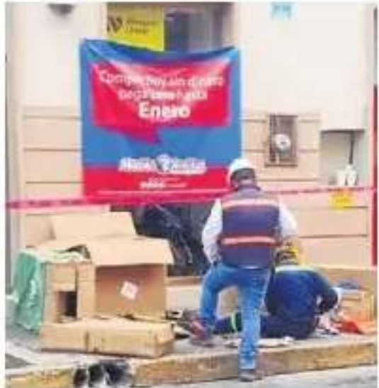
Personal de la CFE revisó la causa de la falla en el registro subterráneo.
