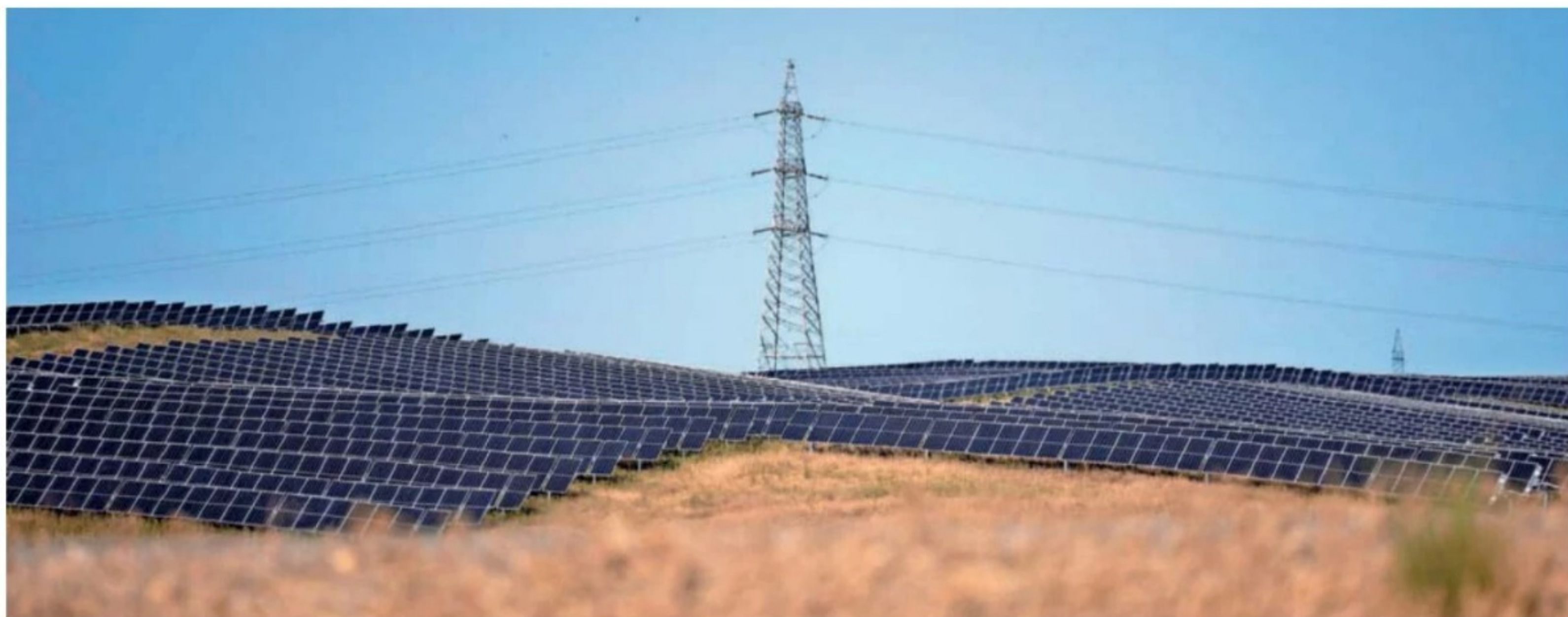
Placas solares en Guilleña, Sevilla. PACO PUENTES
